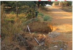
Voçoroca em rua sobre o Córrego.
