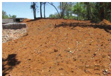
Solo não compactado no interior da obra.
