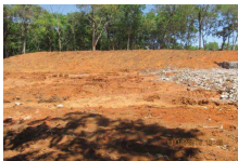
Talude sem cobertura vegetal e ponto de lançamento da drenagem.
